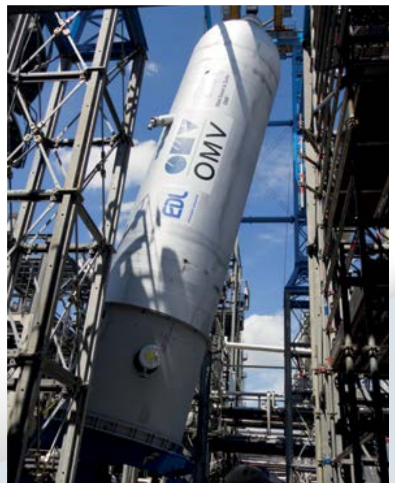
Торжественный момент: новый реактор HDS3 поднят и установлен на фундамент без дополнительной подгонки.
