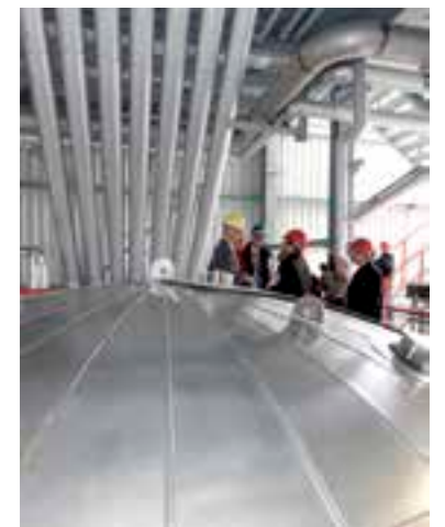
Formalin-Anlage der Lanxess, Silberkatalysatoren-Verfahren
