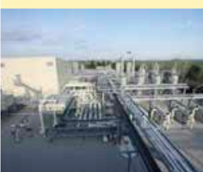
Erdgasanlage in Schönkirchen, Reyersdorf für die OMV, 2008
