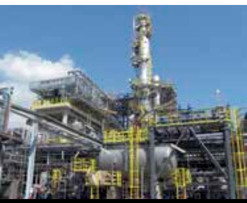
OMV, Entschwefelungsanlage HDS1, 2008
