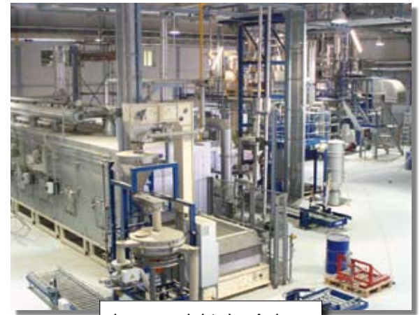
Innenansicht der Anlage
